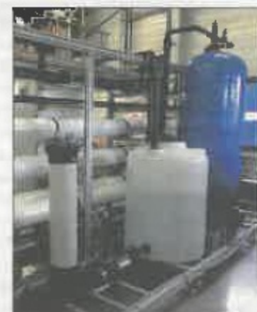
Module d'osmose inverse
