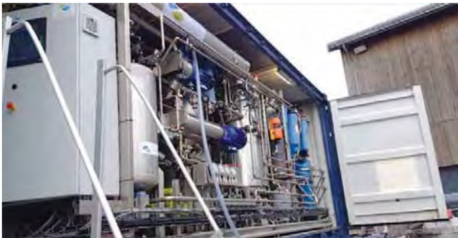
Exemple d'unité mobile développée et construite par l'entreprise pour l'extraction d'eau et d'engrais à partir de boues de méthanisation
