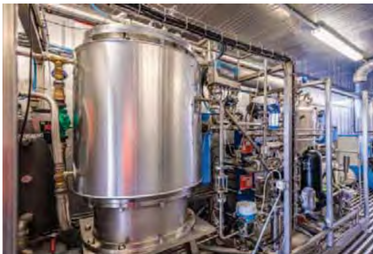
Exemple d'unité développée et construite par l'entreprise pour le recyclage des eaux grises d'un éco-quartier à Anvers
